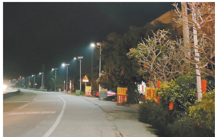
蚬冈镇人大助力省道275线合山桥至金鸡段和乡道YD24线蚬冈加油站至赤水交界路段安装路灯。
