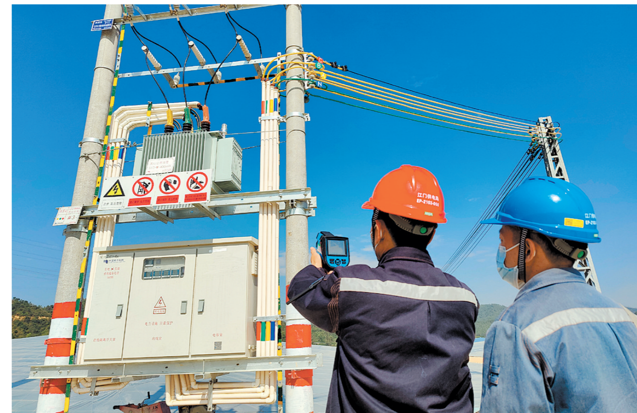
恩平供电局工作人员仔细巡视养殖基地的线路和设备。
