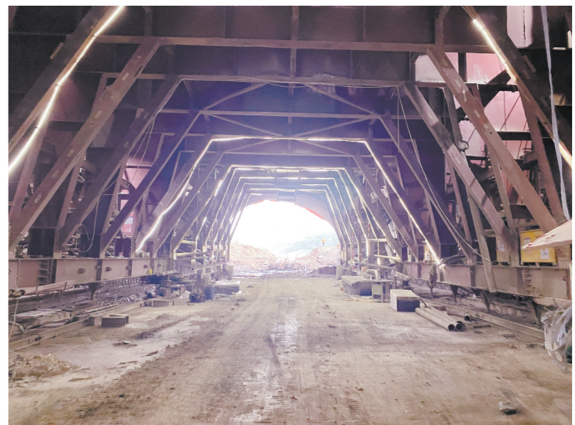
圭峰山隧道顺利贯通,为银洲湖高速公路2024年建成通车奠定了坚实基础。
