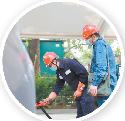
江门供电局工作人员巡检充电桩。
