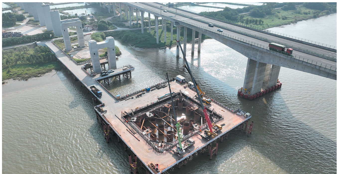
施工人员对深江铁路跨虎跳门水道主桥17号主塔进行混凝土封底灌注。
