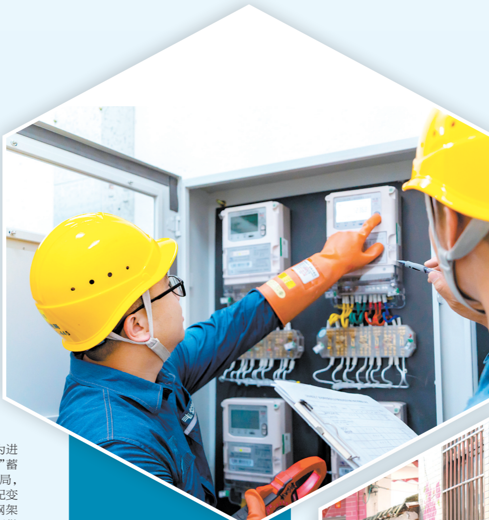
◀今年9月，新会供电局开展工业园区“转改直”抄表到户升级改造工作。
