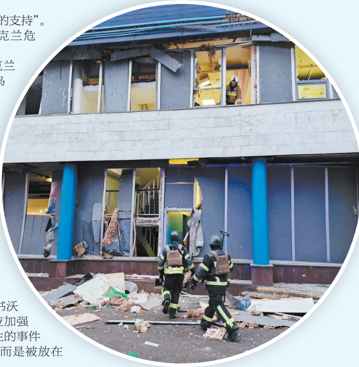
▲1月18日，在乌克兰首都基辅市，乌国家紧急情况局工作人员在受损的建筑内搜救。
