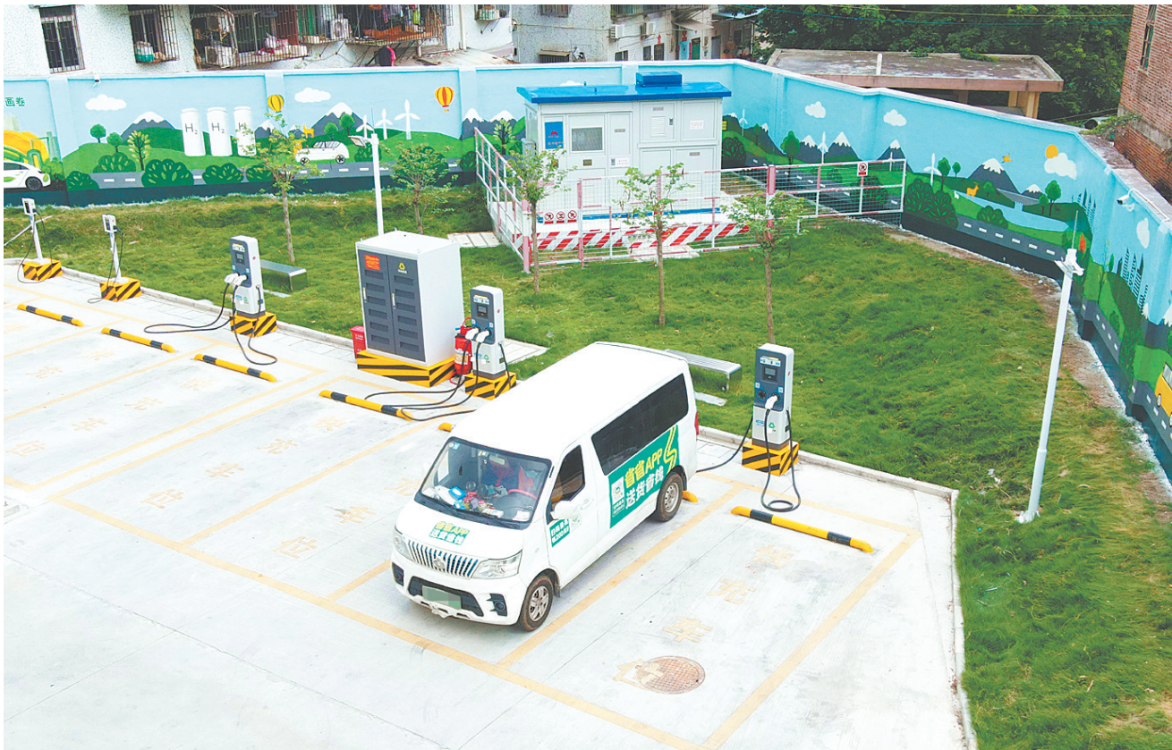
新建的荣汇世家小区侧充电站设施方便快捷,环境干净整洁。
