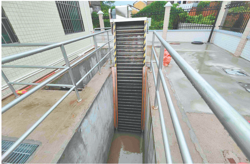
潭溪污水处理厂配备一套高效的污水净化系统，图为滤掉污水大块杂质的格栅池。
