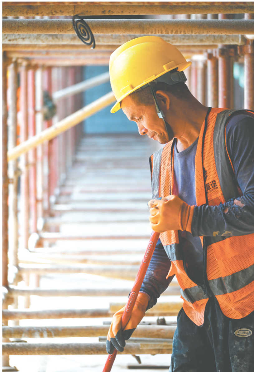
钢架之间,墙角之处,一串串蚊香悬挂着,形成无形的防护屏障。
