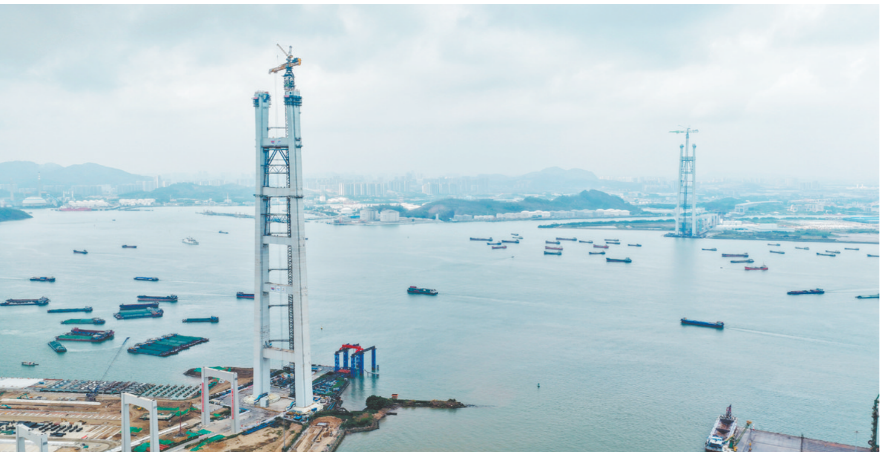
这是3月26日拍摄的狮子洋大桥东、西主塔(无人机照片)。新华社发
