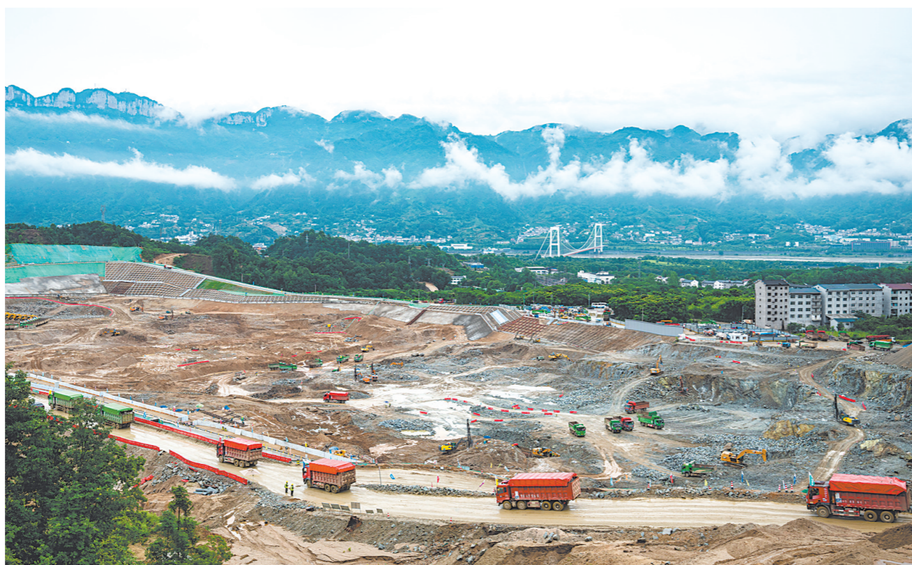
这是6月8日拍摄的三峡水运新通道工程先行开挖区施工现场。新华社发
