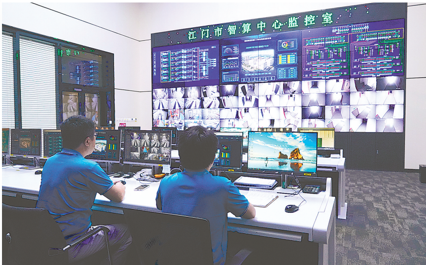
正在工作中的江门市智算中心监控室。
