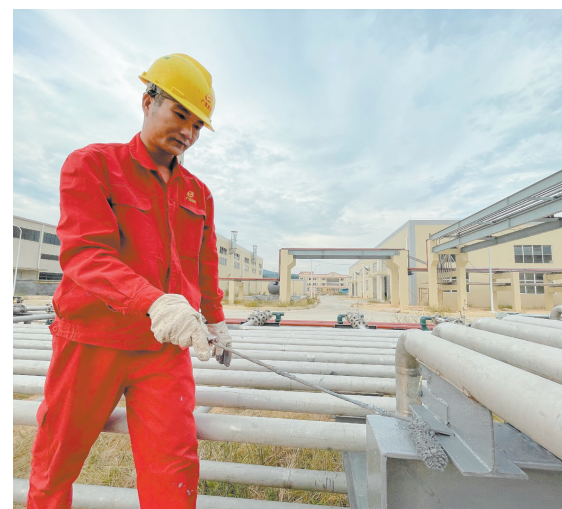
推进更高水平的对外开放将为鹤山中欧合作区建设带来更多机遇。图为在广东晟然绝缘材料有限公司项目建设现场，工人正在为管道刷油漆。
