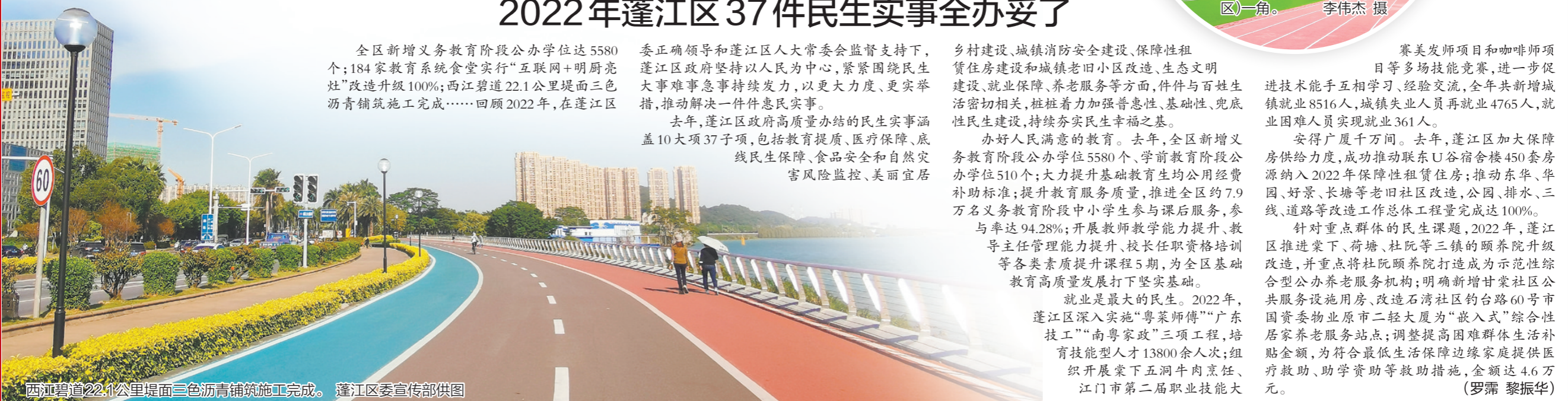
西江碧道22.1公里堤面三色沥青铺装施工完成。蓬江区委宣传部供图
