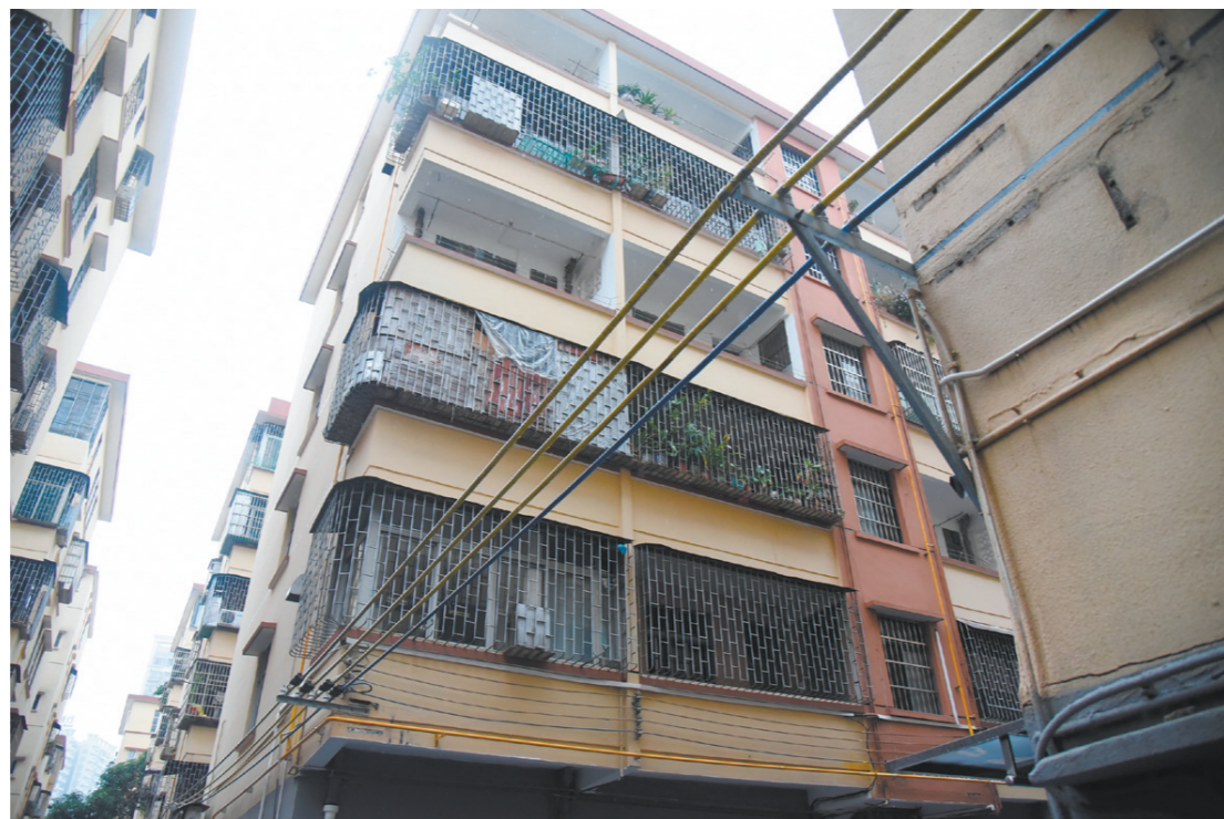
老旧小区改造后,“三线”整治效果显著,“蜘蛛网”已成过去式。
