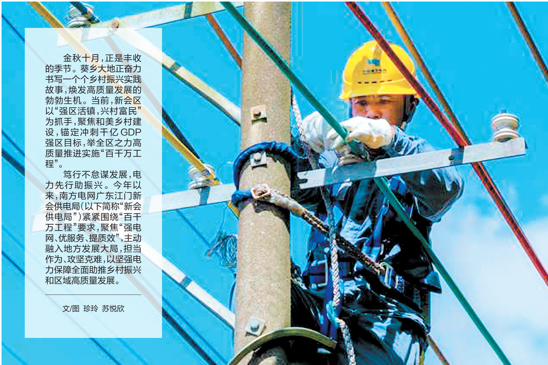
新会供电局持续开展电网的再优化、再升级工程,把低电压治理作为融入和服务“百千万工程”的着力点。
