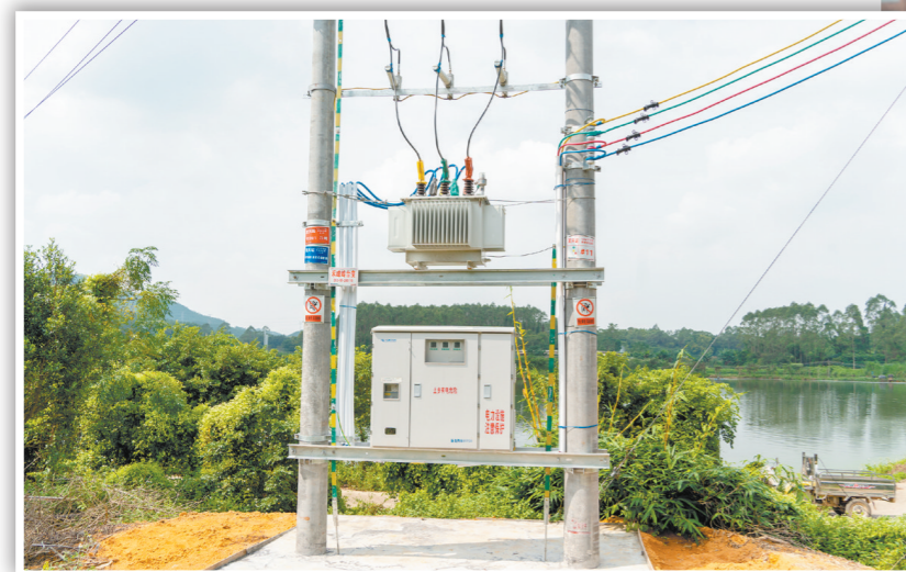
▲禾峰岭村前新建的200千伏变压器正式投入使用。
