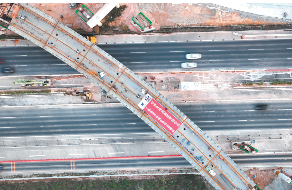
项目部对钢箱梁顶推实现精确控制,为后续施工积累了宝贵经验。
