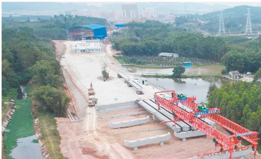
开平推进国道G325线改建工程建设,进一步改善城区国道服务水平和出行条件。
