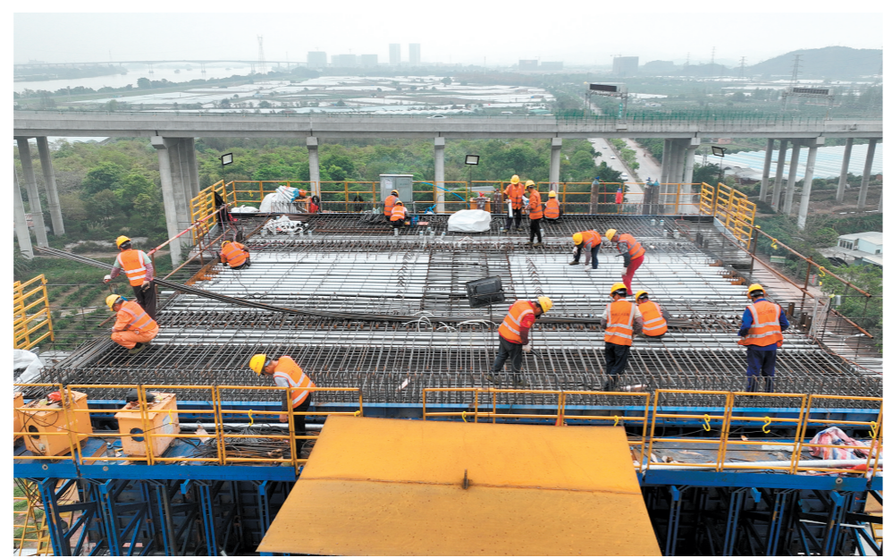
五一假期,深江铁路项目施工现场依然一派繁忙景象,图为工人在进行钢筋绑扎。
