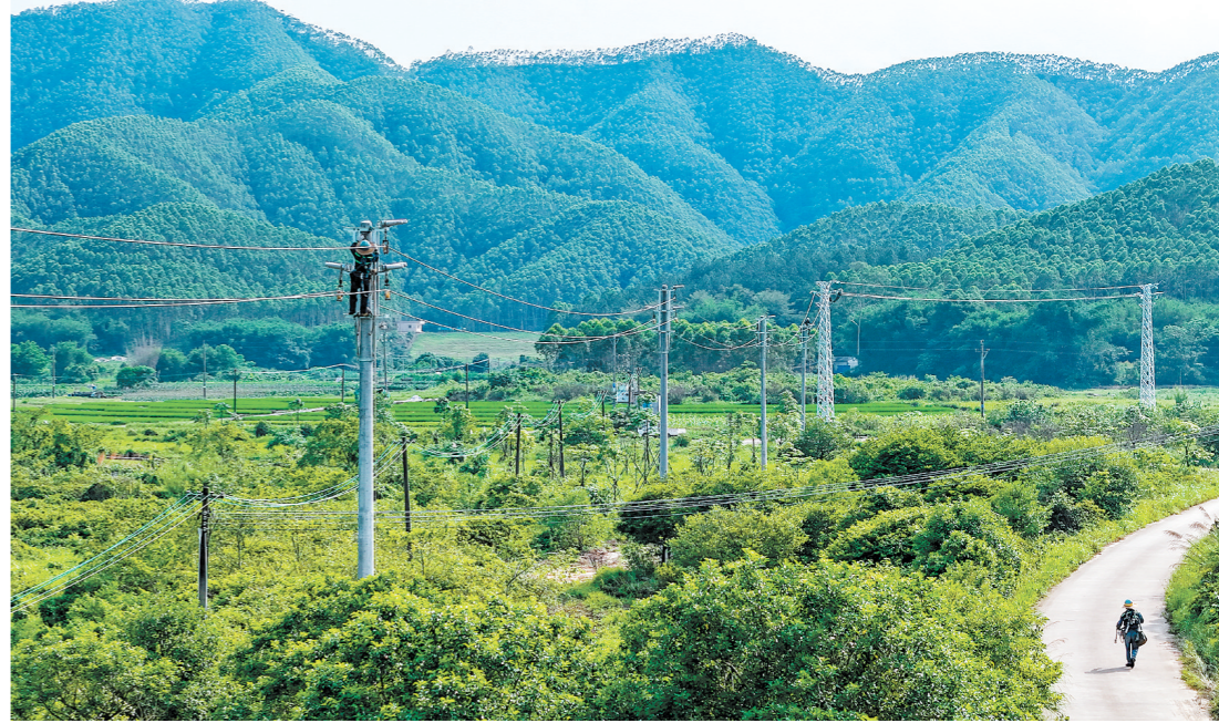
10千伏赤微线的投运,进一步提升了江门中微子实验室的用电可靠性。
