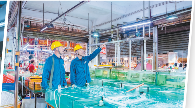
江门台山供电局工作人员主动上门,协助海产品加工、海鲜市场等用户检查用电设备。
