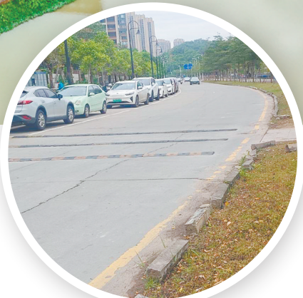
←改造前的桂香路为双向单车道，混凝土路面开裂明显，路缘石破损严重。
