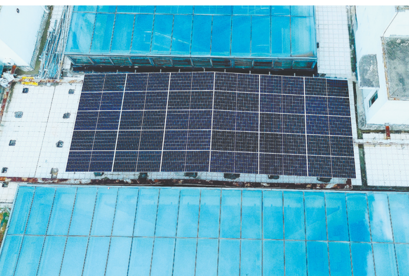
台山市档案馆建筑屋顶上,一片深蓝色的“光能矩阵”正悄然形成。
